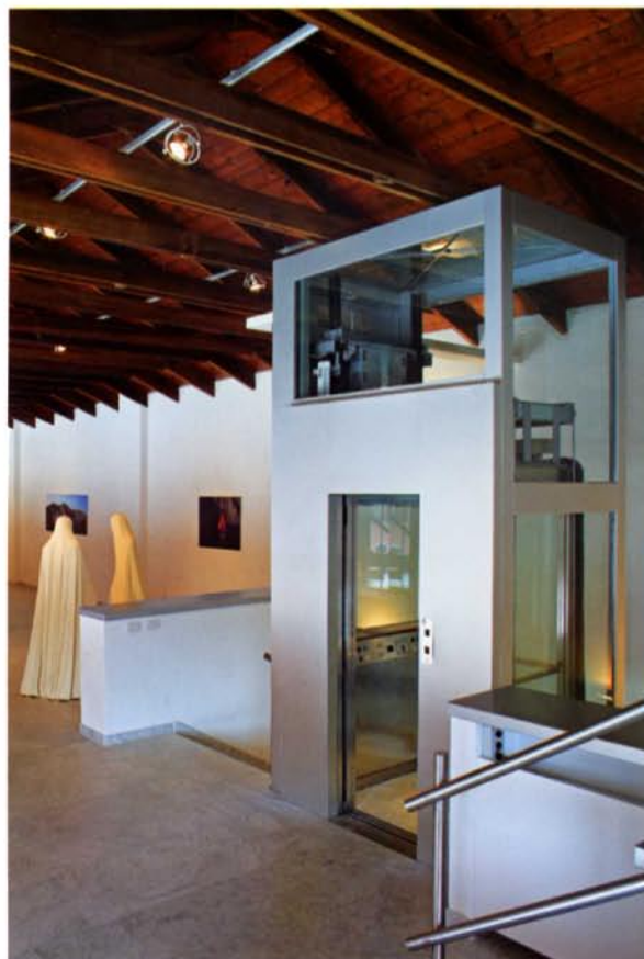
Nella foto, ascensore mod. Superdomus® di IGV con fossa di dimensioni ridotte, progettato su misura, nel museo MATERIMA di Casalbeltrame (Novara).
